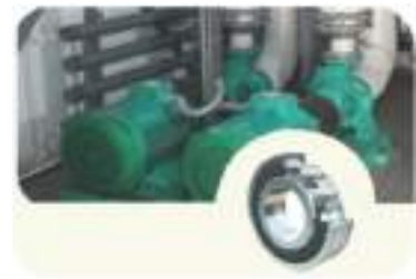
BOMBAS VENTILADORES MOTORES
