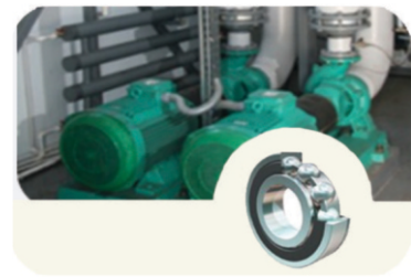
BOMBAS VENTILADORES MOTORES
